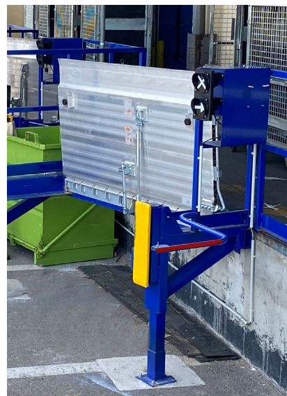
Détection de camion couplée avec feux d'autorisation
