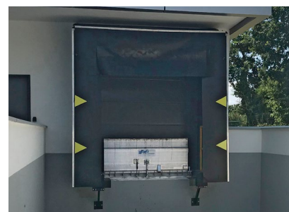
GBAS 0822 sur châssis zone refuge
