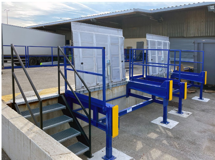
GBAS 1820 sur châssis zone refuge
